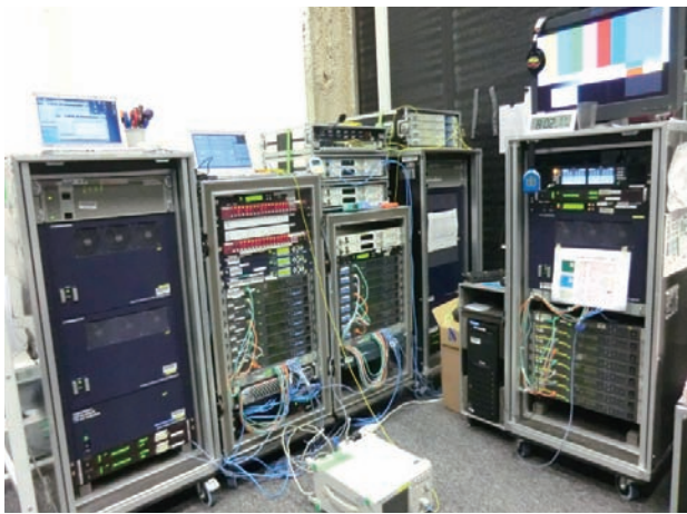
■写真14. IBC伝送装置の設置状況
