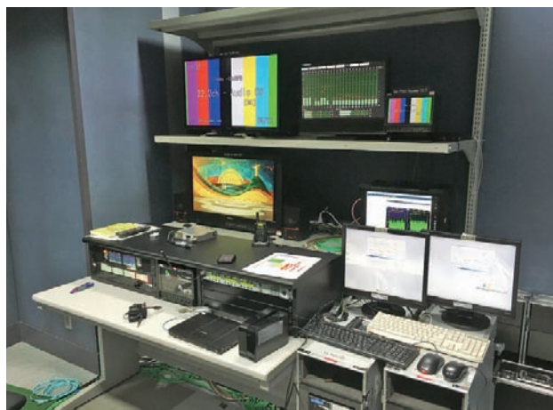
■写真15. CS302スタジオ モニタ設備
